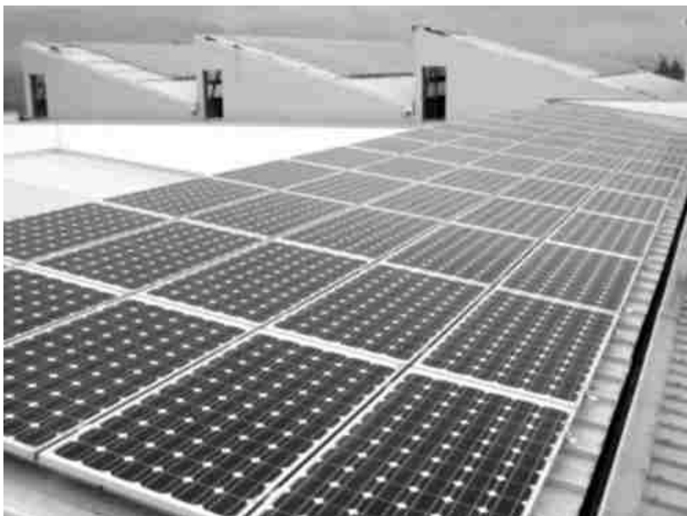
Slika 8: Sončna elektrarna na strehi novega objekta
